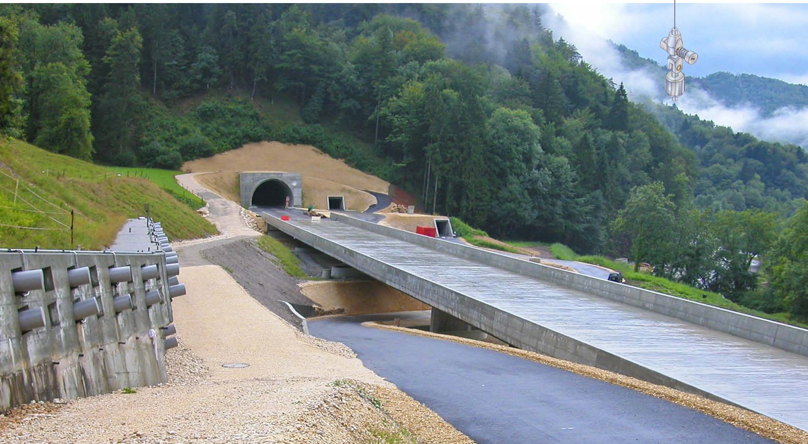
Autoroute A16 Transjurane, construction du tronçon Roches-Moutier, Canton Berne: Mesures Trivec dans un mur de pieux
