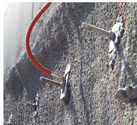
Ancrage de mesure avec extensomètre
