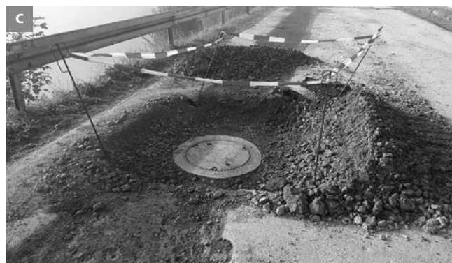
Bild 3 a) Installation des Sondiergestänges; b) Muffe mit faseroptischen Verbindungen; c) fertig gestellter Schutzschacht
