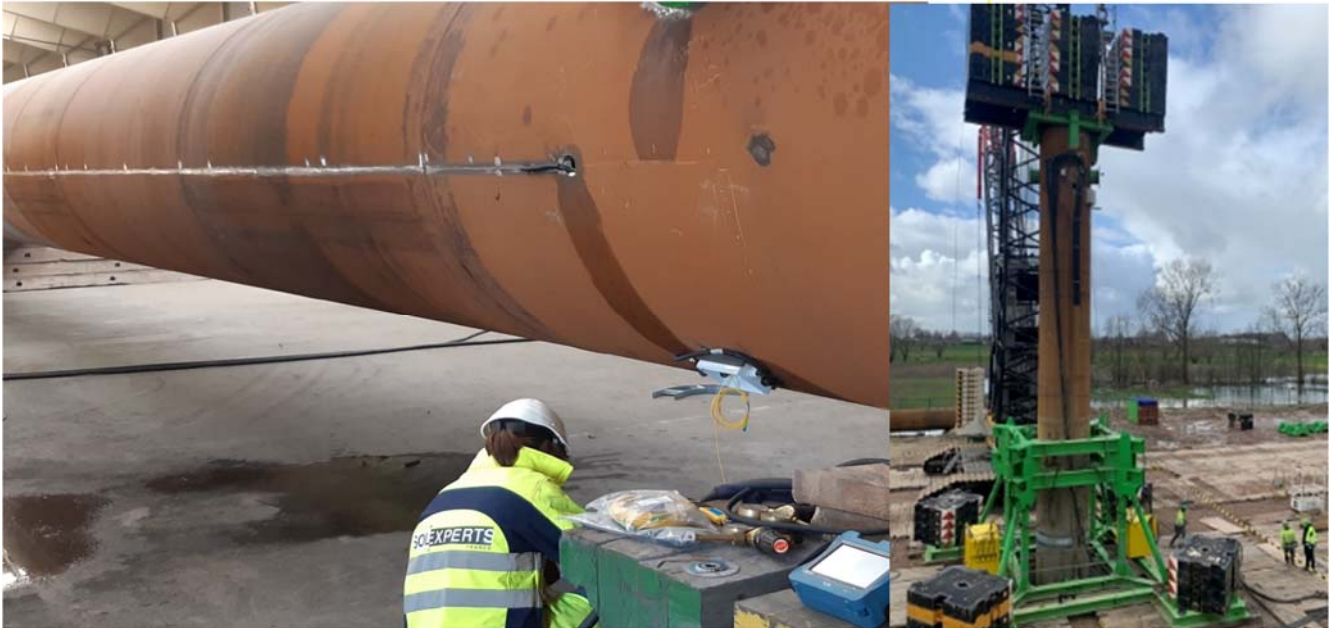
Mesures de déformation corrigées en température via fibres optiques collées sur des pieux d'éoliennes (NL/BE)
