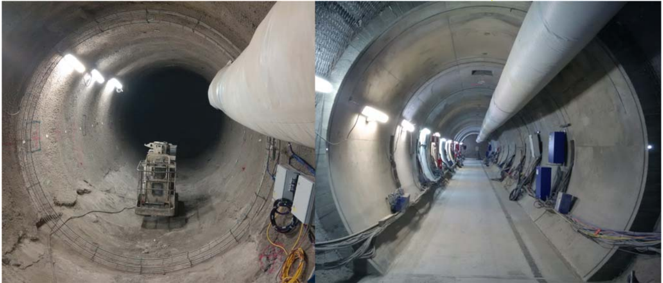
Mesures de déformation réalisées sur des fibres optiques installées dans le soutènement d'une galerie, CMHM (FR)
