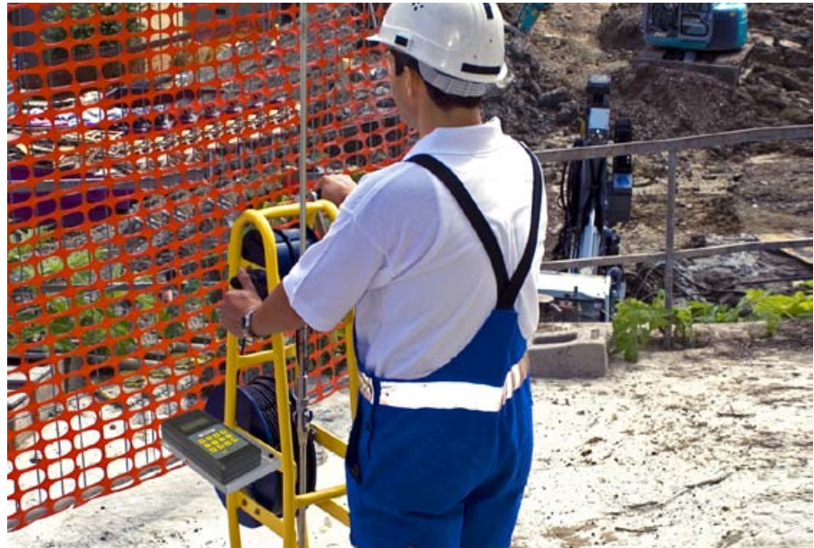
Gleitdeformeter - und Gleitmikrometermessung mit dem MRD
